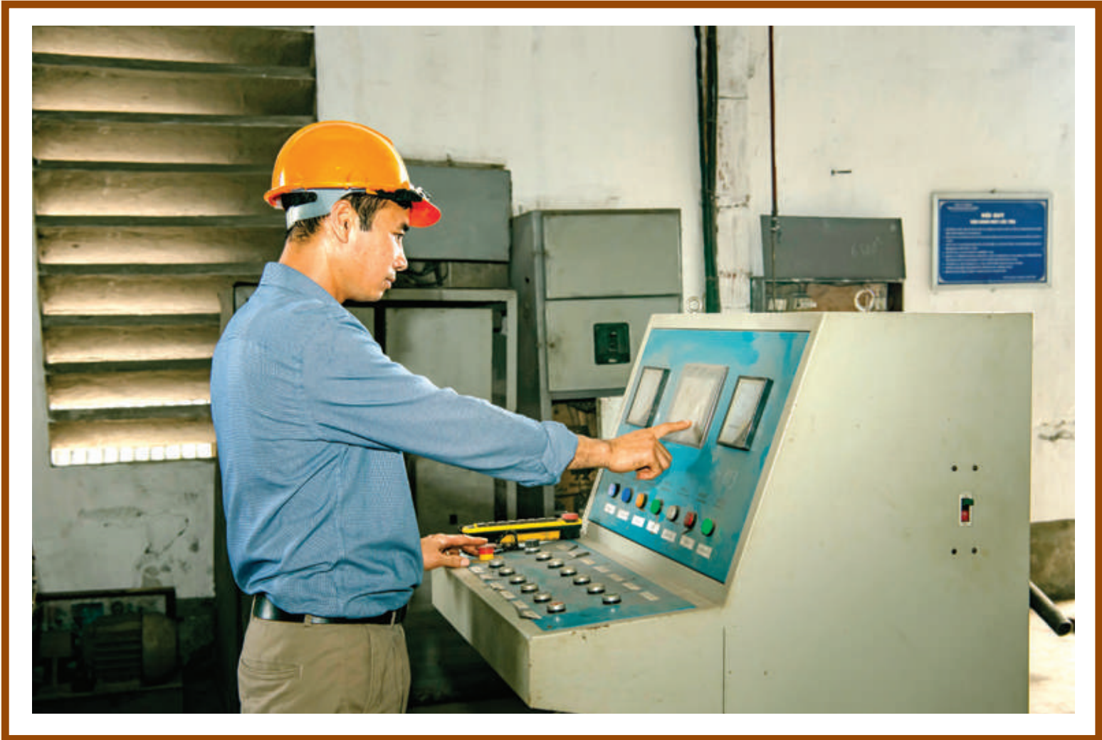
Hệ thống điều khiển máy lọc tôn số 2 lắp đặt năm 2019.
