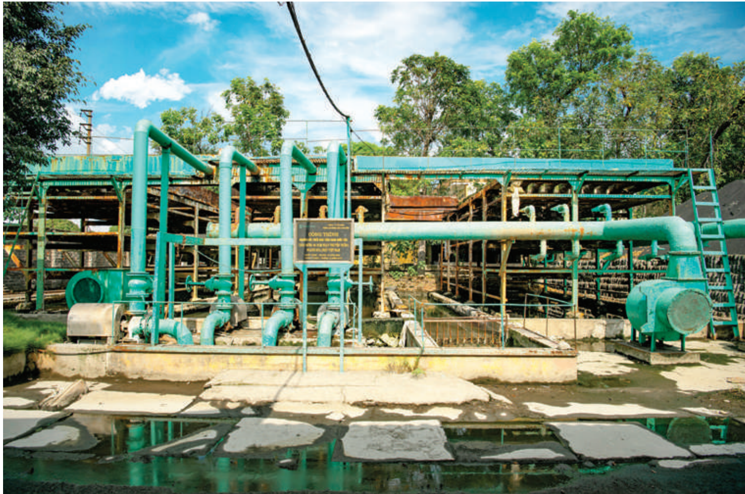
Giàn trao đổi nhiệt làm lạnh một phần nước thải sau cải tạo thành hệ thống tuần hoàn 100% nước thải năm 2013. Công trình chào mừng 45 năm ngày truyền thống ngành Hóa chất.
